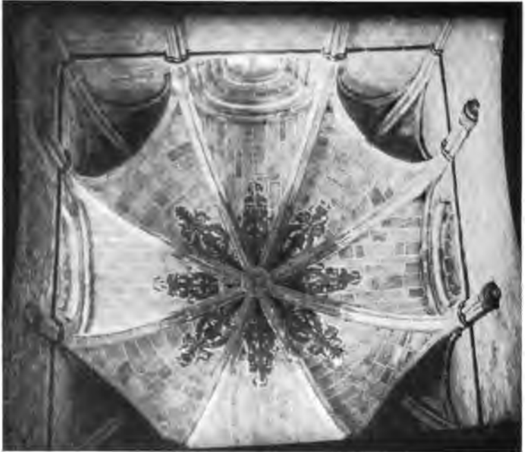
Fig. 142. — Voûtes angevines raccordées aux quatre angles par des voûtes triangulaires sur le transept de l'église San-Pedro d'Avila. Appareil des remplissages suivant les parallèles de la sphère pour les triangles de voûtes compris entre les pénétrations des baies du tambour.
